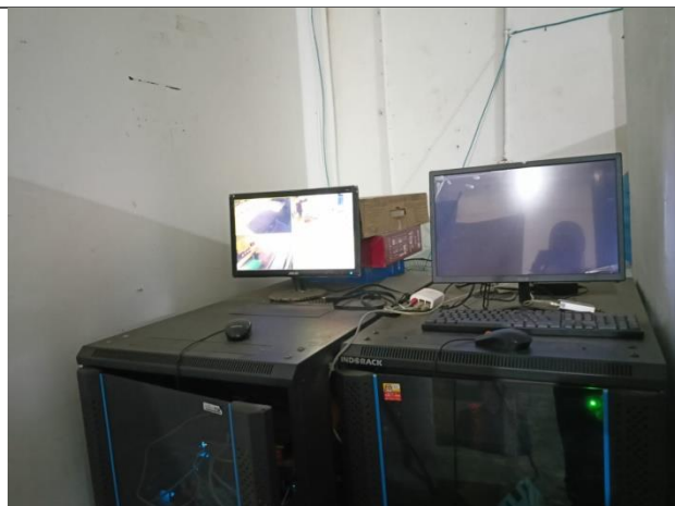
RUANG KONTROL CCTV DAN SERVER
